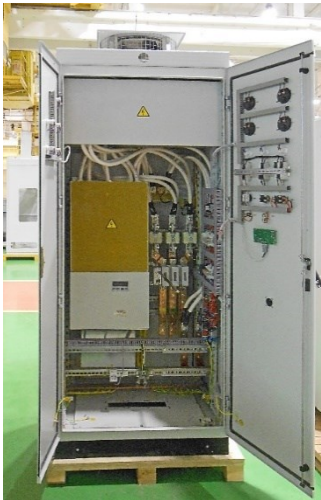
Шкаф управления для волочильного стана с ЭПУИМ-7
